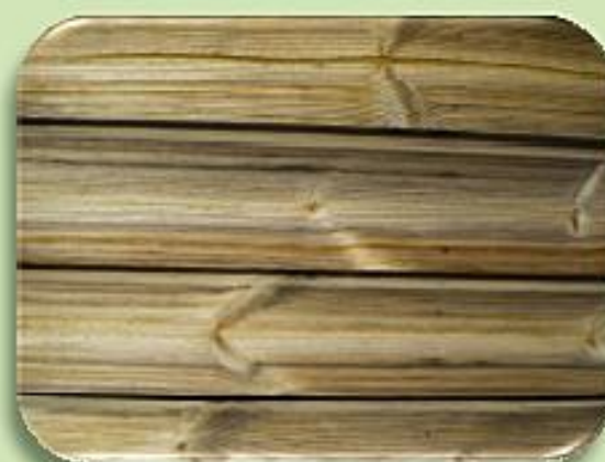
Fasádní obklad bez nátěru – po 5 letech
